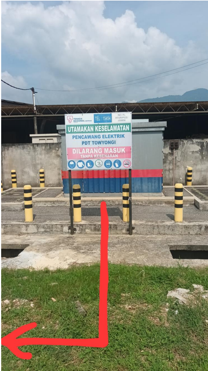
PENCAWANG ELEKTRIK PDT TOWYONGI
