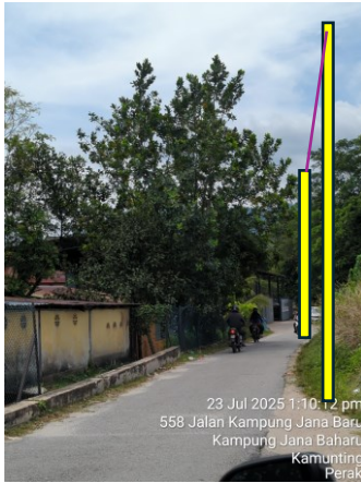
PROP POLE AT JALAN KAMPUNG JANA BARU
