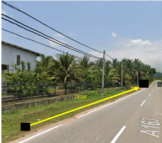
Gambar 1: Kerja kerja menarik kabel 96C UG MH to MH sedia ada (Tidak Berturap)
