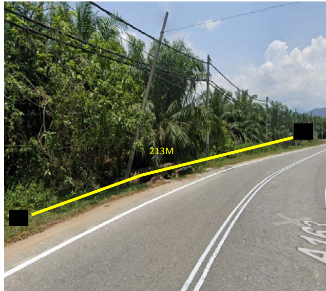
Gambar 4: Kerja kerja menarik kabel 96C UG MH to MH sedia ada (Tidak Berturap)
