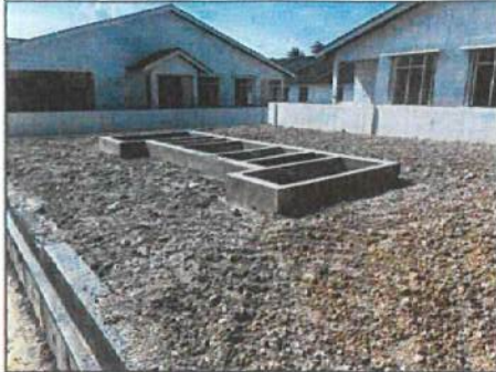
PENCAWANG ELEKTRIK PROJEK PERUMAHAN KIJAL
