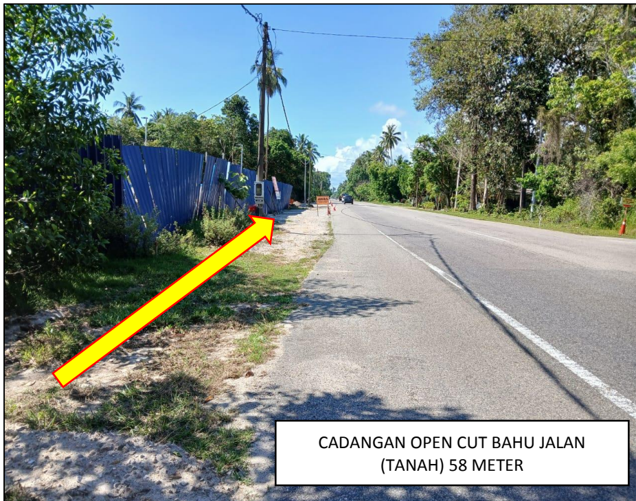
GAMBAR 2 : KAWASAN KERJA MELIBATKAN PEMOTONGAN BAHU JALAN (TIDAK BERTAR) (DARI BANDAR MARANG KE DUNGUN)
