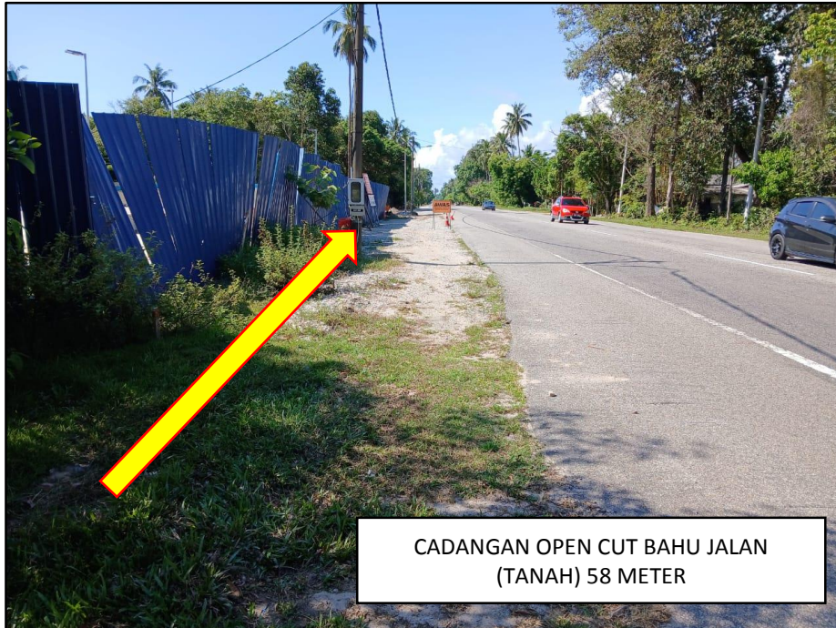
GAMBAR 1 : KAWASAN KERJA MELIBATKAN PEMOTONGAN BAHU JALAN (TIDAK BERTAR) (DARI BANDAR MARANG KE DUNGUN)
