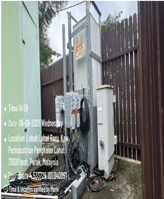
PICTURE 1 : UM T5 CABINET
