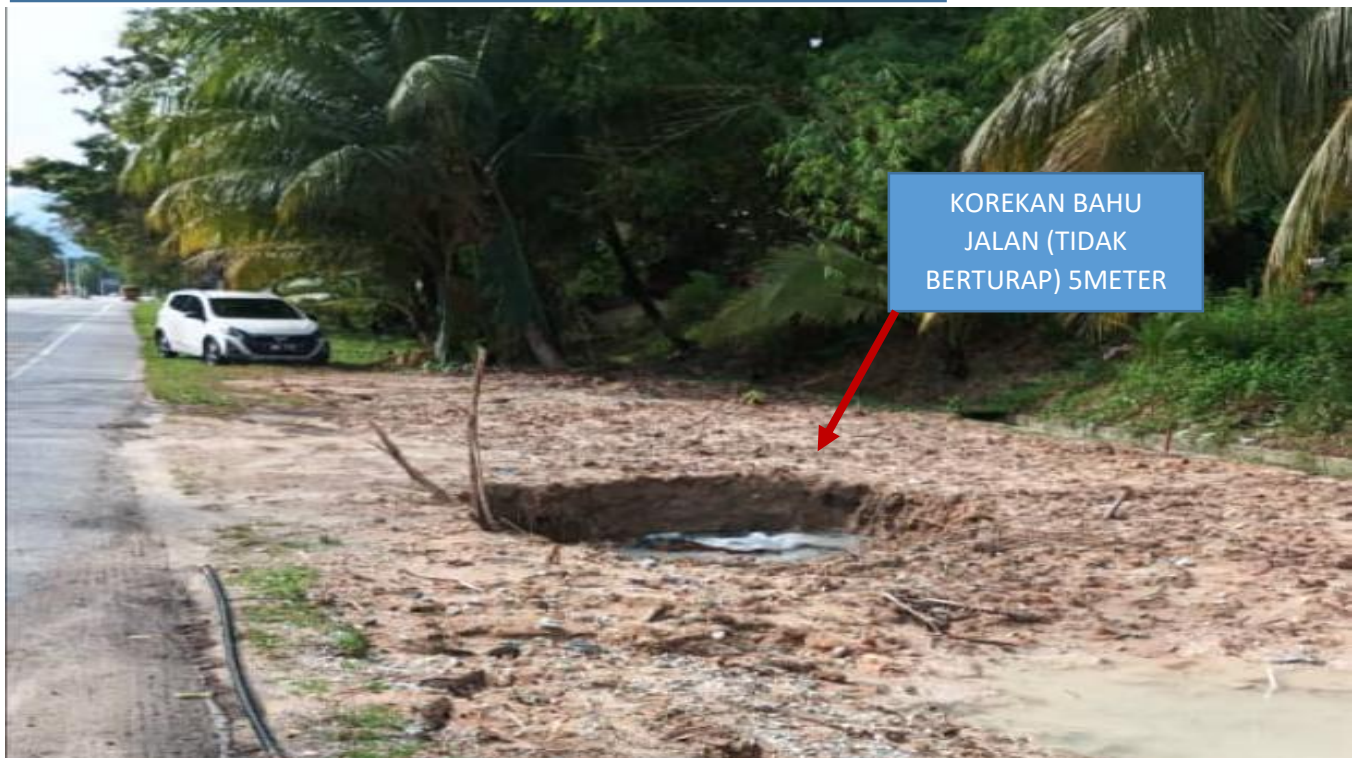
GAMBAR 1: KAWASAN KERJA PENUKARAN PAIP PEMBETUNGAN AWAM PECAH DAN ROSAK DI BAHU JALAN (TIDAK BERTURAP)- OPEN CUT.
