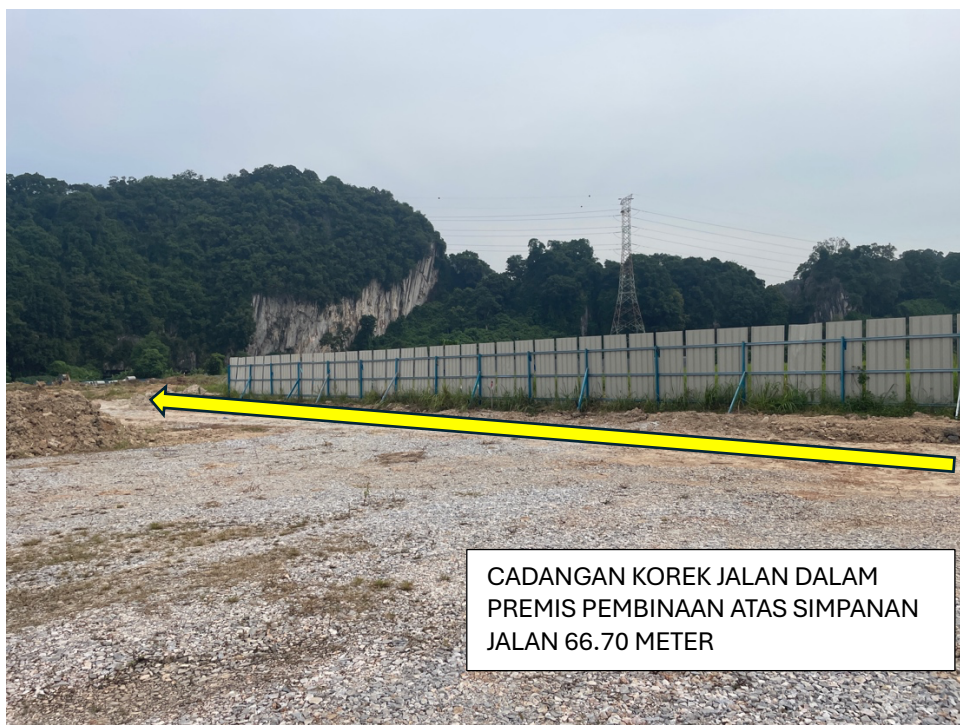
GAMBAR 4 : KAWASAN KERJA YANG MELIBATKAN PENGOREKKAN JALAN (DALAM PREMIS TAPAK PEMBINAAN DI ATAS SIMPANAN JALAN)
