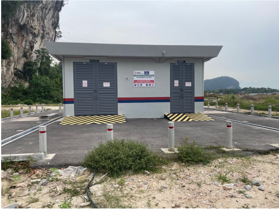
GAMBAR 1 : PENCAWANG ELEKTRIK BARU PT 250282
