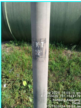
Tiang sedia ada
