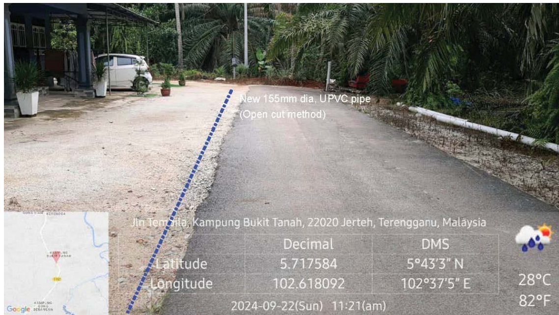
GAMBAR 4 : Kawasan cadangan laluan paip baru pada laluan tepi jalan.
