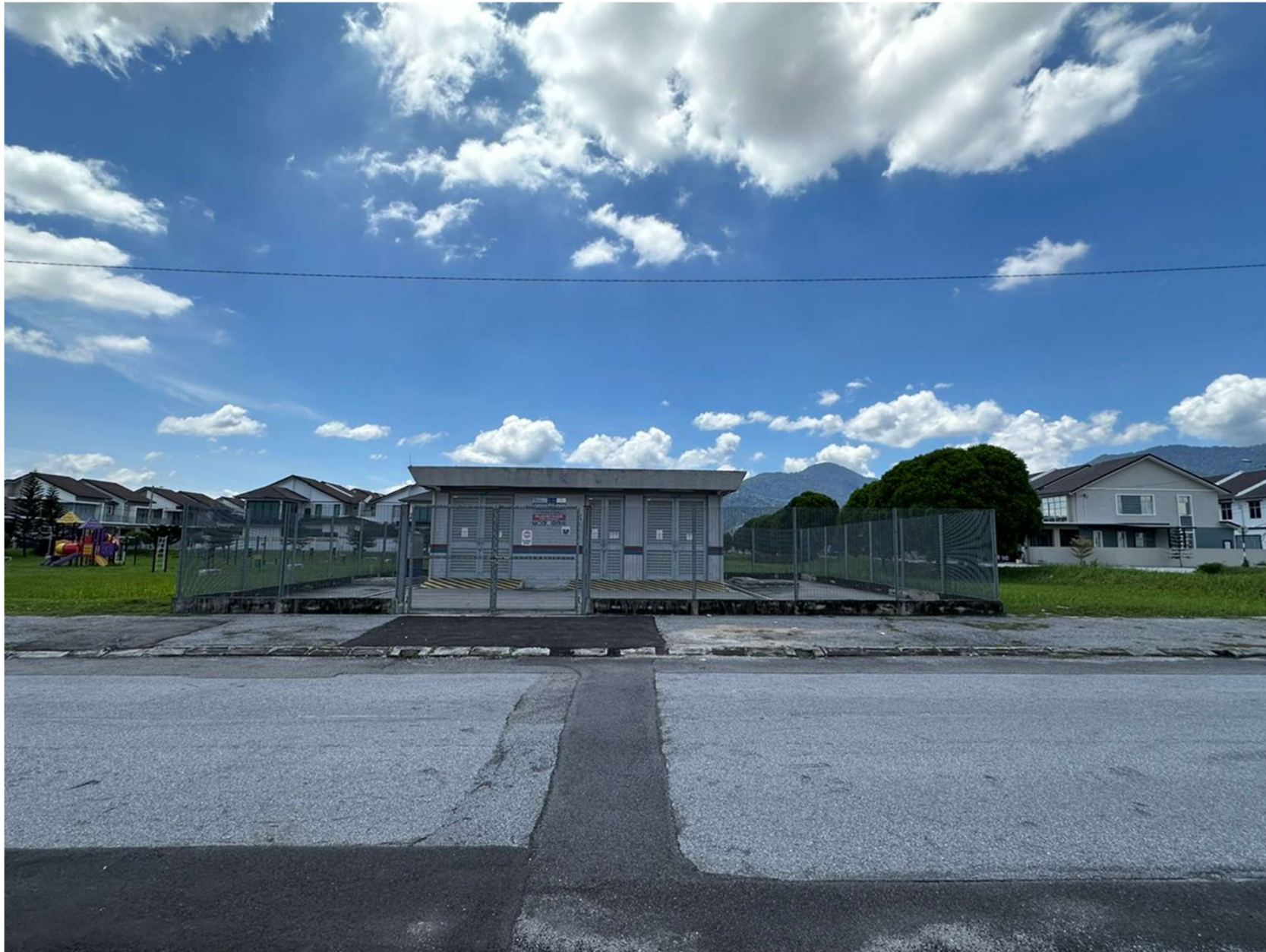
TAPAK PENCAWANG ELEKTRIK
