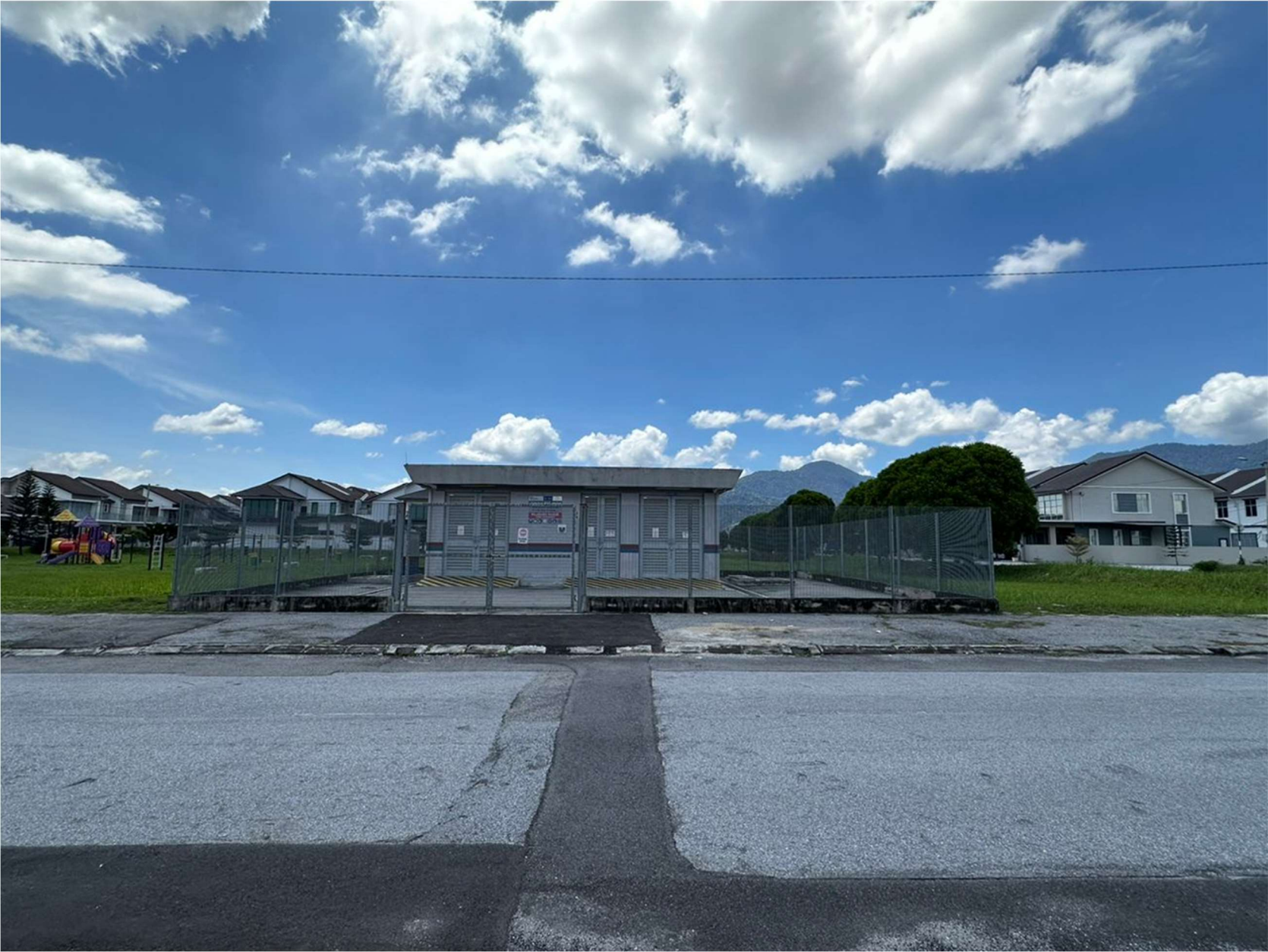
TAPAK PENCAWANG ELEKTRIK
