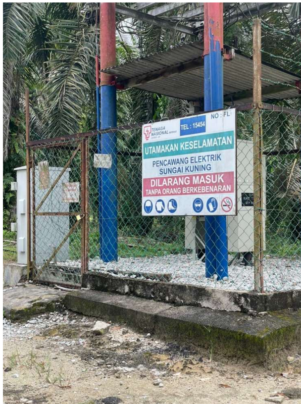
PENCAWANG ELEKTRIK SUNGAI KUNING.
